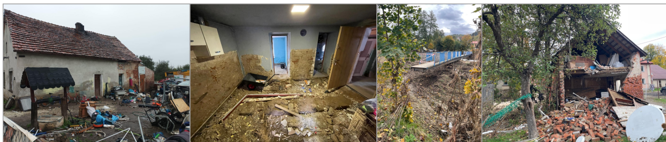
■ Szacowanie strat w terenie. Każdego dnia członkowie naszej Izby oceniali stan techniczny kilkudziesięciu budynków mieszkalnych. Sporządzone przez nich protokoły będą podstawą do wypłaty odszkodowań i pomocy od państwa. (fot. nadesłane)
