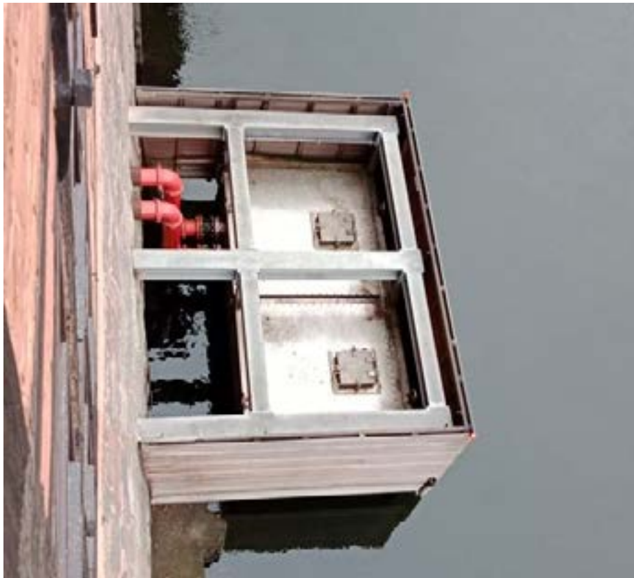
Pompa ciepła w Młynach Rothera – Bydgoszcz – wykorzystanie rzeki jako dolnego źródła ciepła
