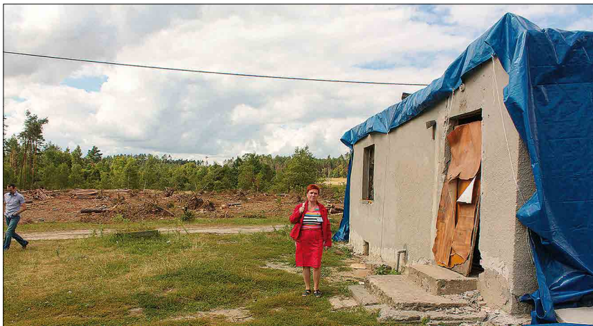
■ Krystyna Szerszyń przy zniszczonym budynku Andrzeja Kamińskiego w Zdrojach. PINB orzekł tu stan katastrofy budowlanej. Fot. Tadeusz Kozłowski
