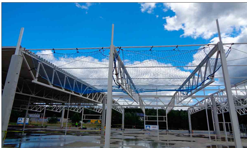
■ ERBUD S.A. stosuje nowatorskie środki bezpieczeństwa, które nie są jeszcze standardem na polskich budowach. Na zdj. siatki chroniące przed upadkiem podczas montażu poszycia dachu Fot. Arch. ERBUD S.A.
