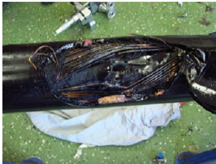
3. Widok miejsca przebicia kabla
