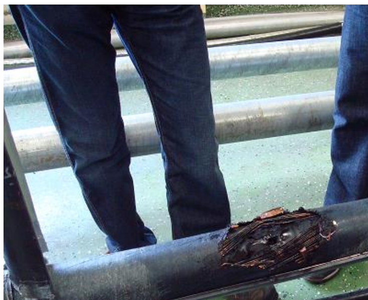
4. Widok miejsca i rozległości uszkodzenia kabla
