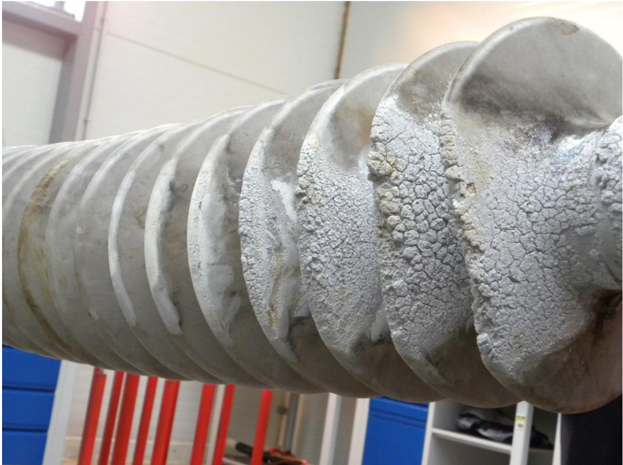
14. Widok uszkodzonych kloszy izolacyjnych głowicy kablowej na skutek palącego się łuku .
