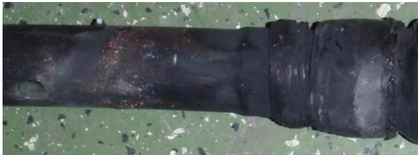
8. Widok miejsca przebicia kabla na wysokości zakończenia stożka sterującego korpusu głowicy
