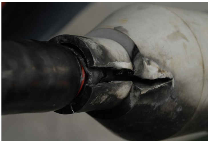
6. Widok zewnętrznych skutków uszkodzenia głowicy
